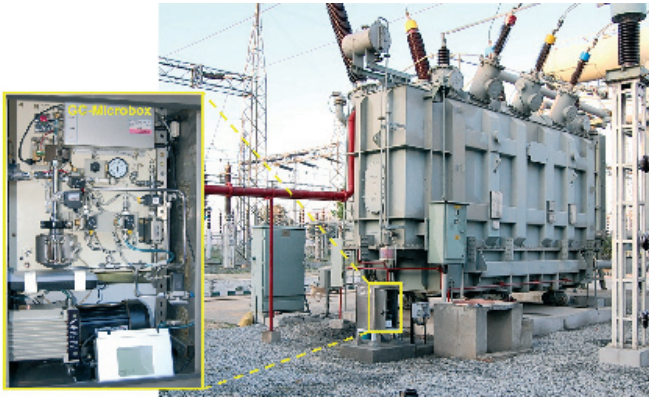
Der Analysenschrank (Abb. 1) von Tovia arbeitet mit GSM- bzw. GPRS-gestützten Messdatenübermittlung.
